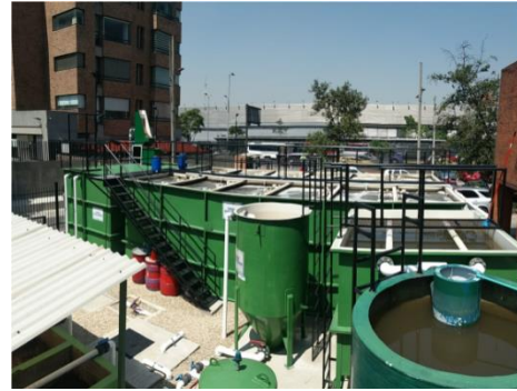
Ilustración 1 Planta de tratamiento Hospital Universitario Mayor
