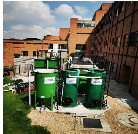
Ilustración 2 Planta de tratamiento Hospital Universitario Barrios Unidos
