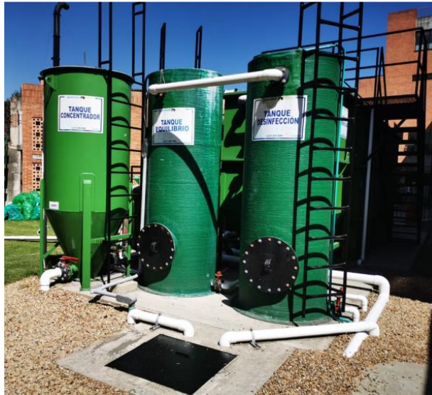
Ilustración 5 Tanques de desinfección
